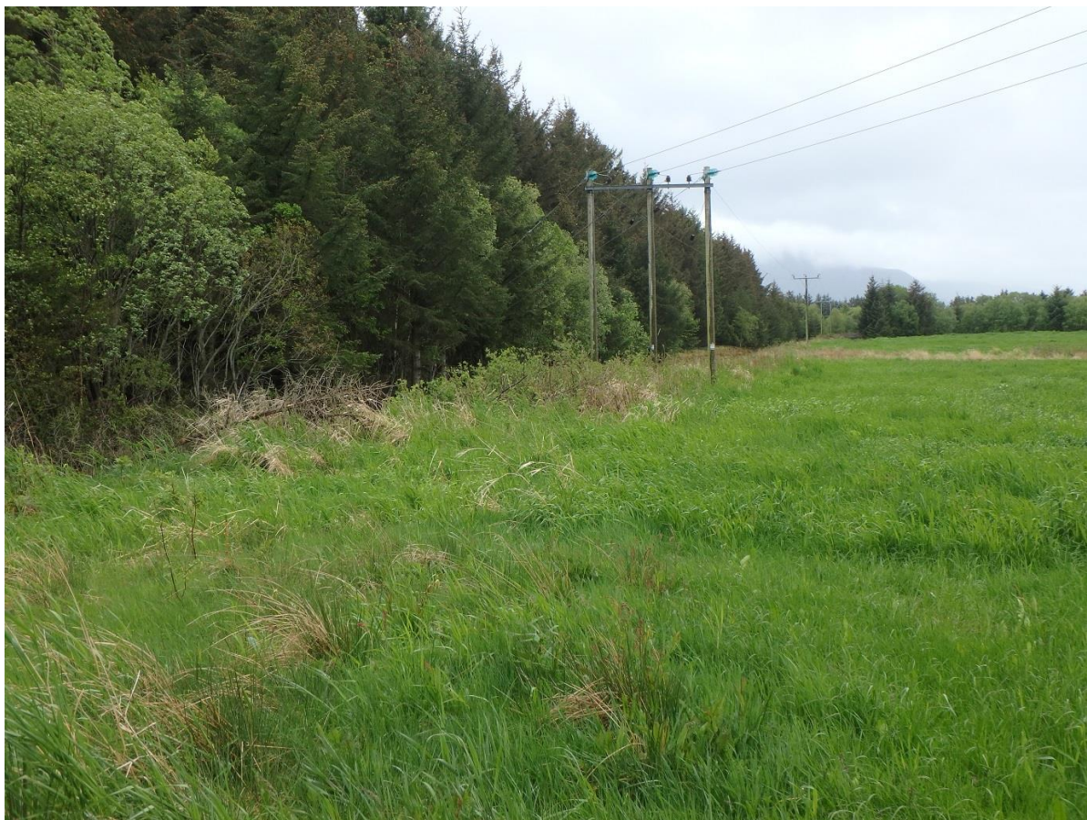
Figur 7 Døme på kraftline med leplanting nær inntil på Gossen, Aukra kommune. Om nokre av trea nær lina her går over ende og i retning av kraftlina, må ein rekne med straumbrot med dei samfunnskostnadene det fører til. Foto: Øystein Folden
