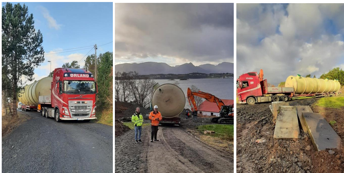
Figur 25: Den nye slamavskillaren på Nerbøstranden rommar heile 100 m 3 . Den er 15 meter lang og 3,5 meter høg.
